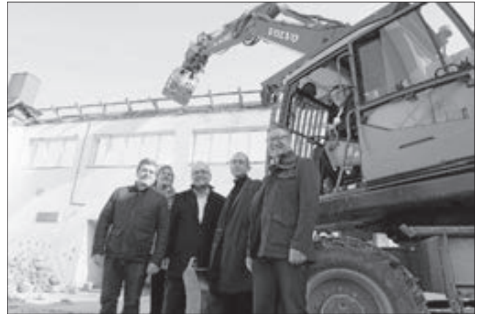
v. l. n. r. Architekt Franz Eisele, Daniel Schmid von der Abbruch-Firma BERB, Bürgermeister Walter Klumpp, Stadtbaumeister Holger Kurz, Jürgen Wenzler vom Bauamt und Ortsvorsteher Karlheinz Ullrich
